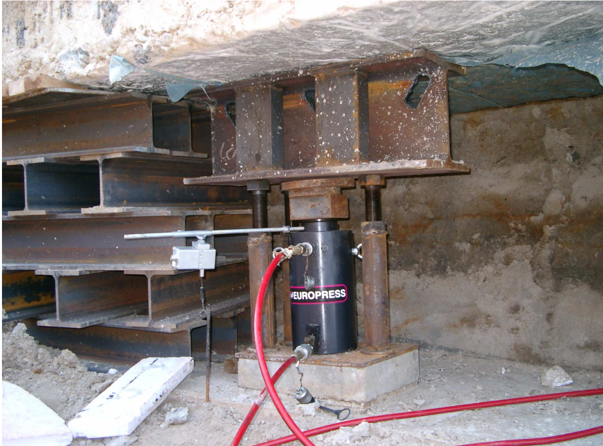
Bild 3 Eine der 50 hydraulischen Hebepressen und ein Stahlpaket zur Aufnahme der Horizontallasten
